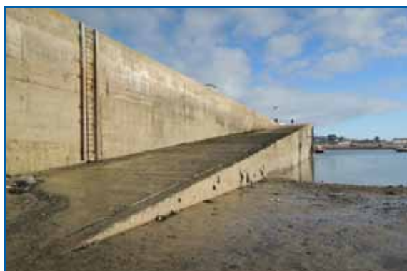
La cale du quai André Déan fait l'objet de diagnostic approfondi, visant à définir les travaux nécessaires à son confortement.
