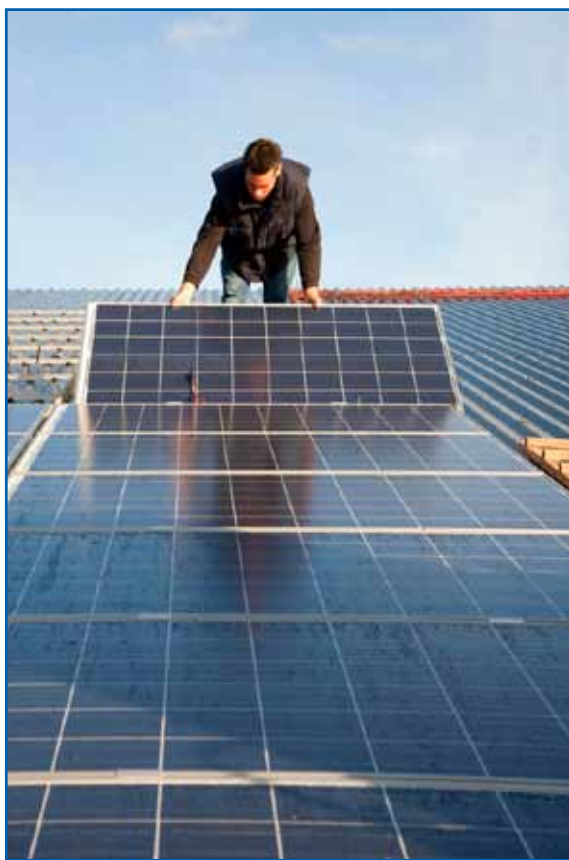
Toiture photovoltaïque - plateforme bois énergie - Pleyber-Christ.
