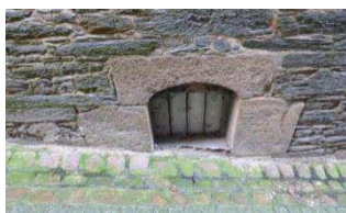
Ouverture de cave obstruée
