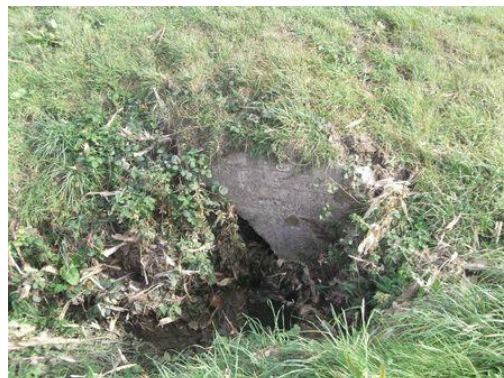
Débris de béton visible dans le fossé
