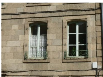
Persiennes disparues, la feuillure qui devait l'accueillir est encore visible
