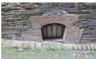
Ouverture de cave obstruée
