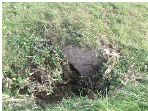
Débris de béton visible dans le fossé
